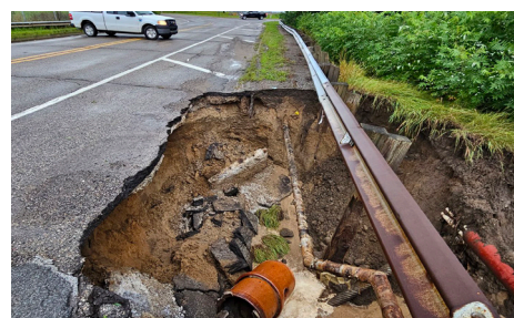
Les fortes pluies des 24 et 25 août ont provoqué l'effondrement de routes dans le canton d'Ypsilanti, au Michigan (crédit : Washtenaw County Roads)
