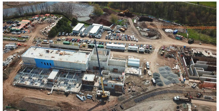
Le bâtiment de traitement tertiaire en cours de rénovation. Source : Ville de Hamilton.
