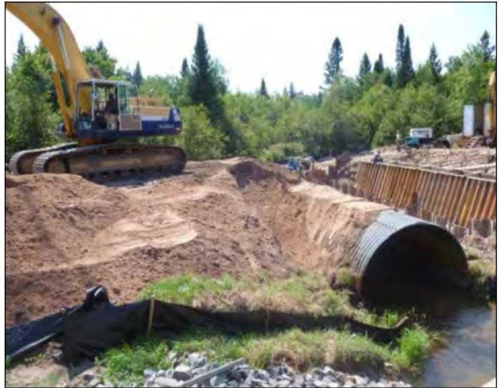
Ponceau Falls River de la rue Golf Course, comté Baraga, Michigan, avant d'être supprimé.
